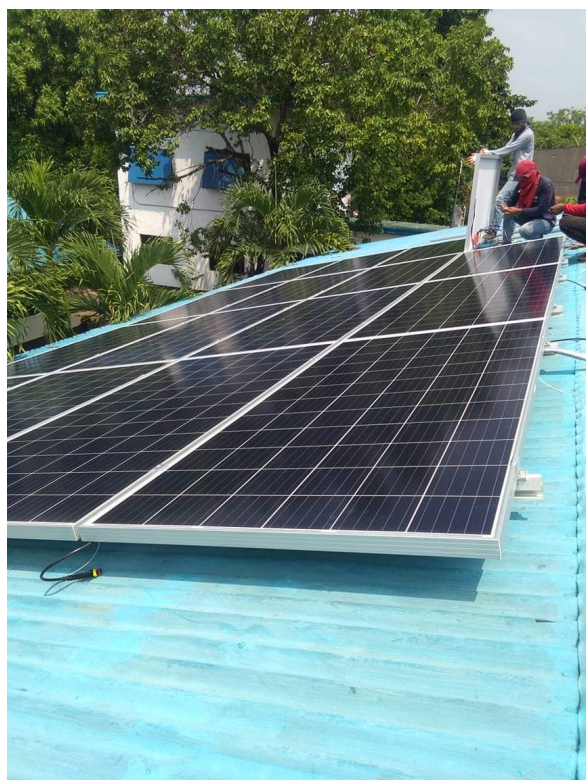
Zonnepanelen op Unit 3
